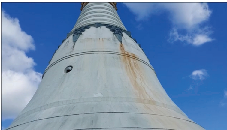
建物表面に出た赤錆
