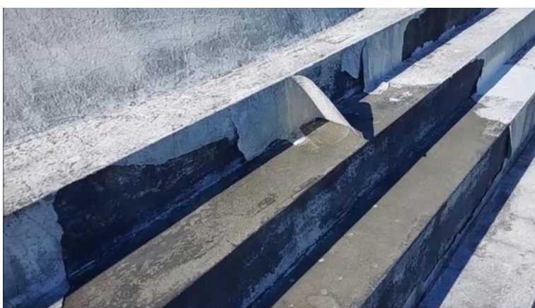
剥げてめくれた塗装
